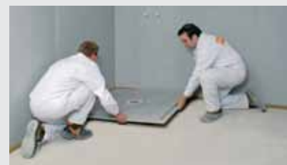
Varianta 1a: ve výši horní hrany korpusu odtoku je v oblasti sprchového prvku stažen rychlotuhnoucí podsyp a umístěn sprchový prvek
